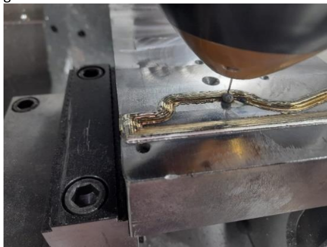
Figura 16 defecto durante la fabricación por deficiencia en la potencia.
