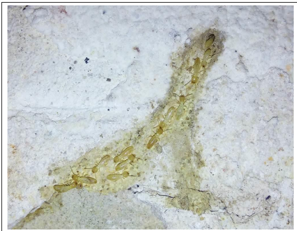
Imagen 5. Termitas en un edificio histórico de la Comunitat Valenciana. Fuente: AIDIMME
