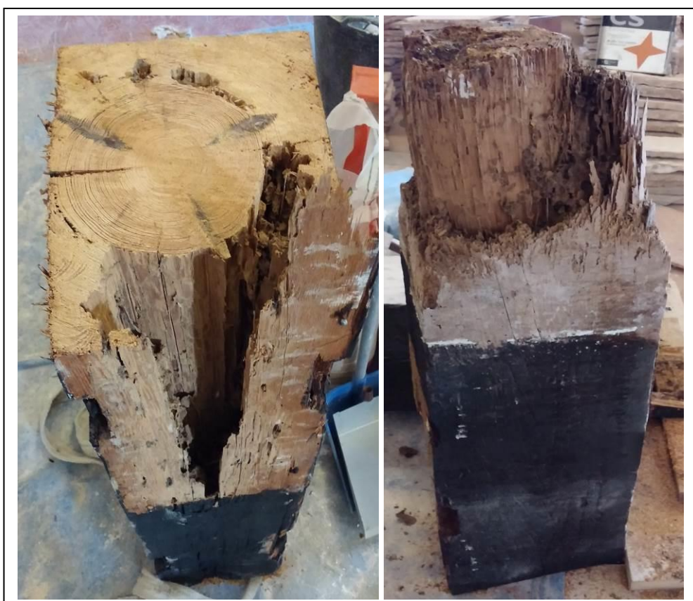
Imagen 1. Degradación de vigas de carga de madera de un palacio renacentista que forma parte del patrimonio histórico valenciano. La degradación ocasionó la curvatura de varios forjados. Fuente: AIDIMME
