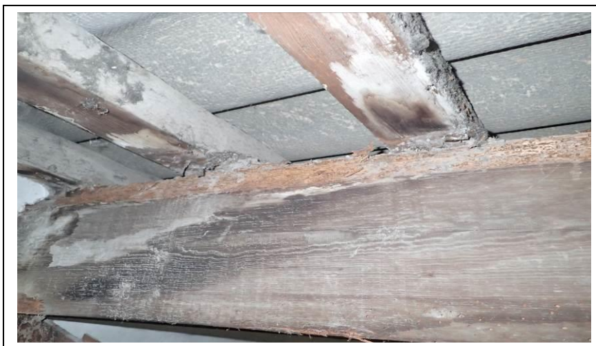
Imagen 3. Degradación por un insecto del género Anobiidae (carcoma fina) de la parte superior de una viga de carga de una nave industrial valenciana del siglo XIX. Fuente: AIDIMME.
