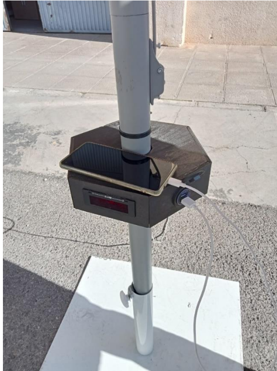
Ilustración 44: Comprobaciones de carga tomas auxiliares
