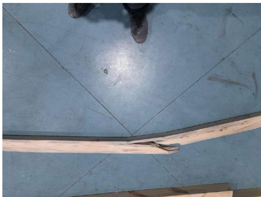
Figura 285. Detalle de roturas producidas.
