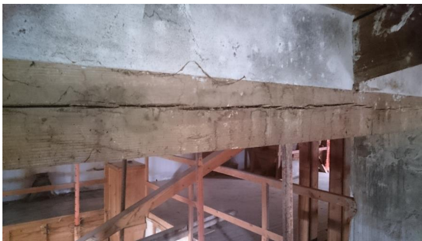
Figura 8. Fendas en una viga de madera estructural. Fuente: AIDIMME
