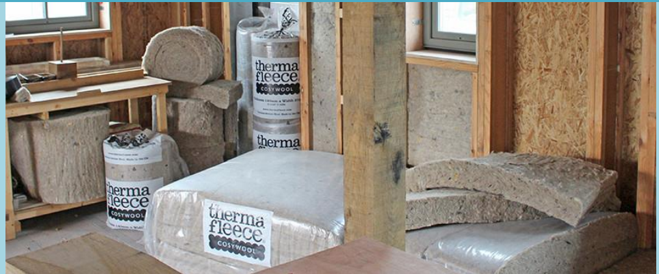
Sistema de aislamiento con lana de oveja donde se aprecian las láminas de OSB contiguas.
