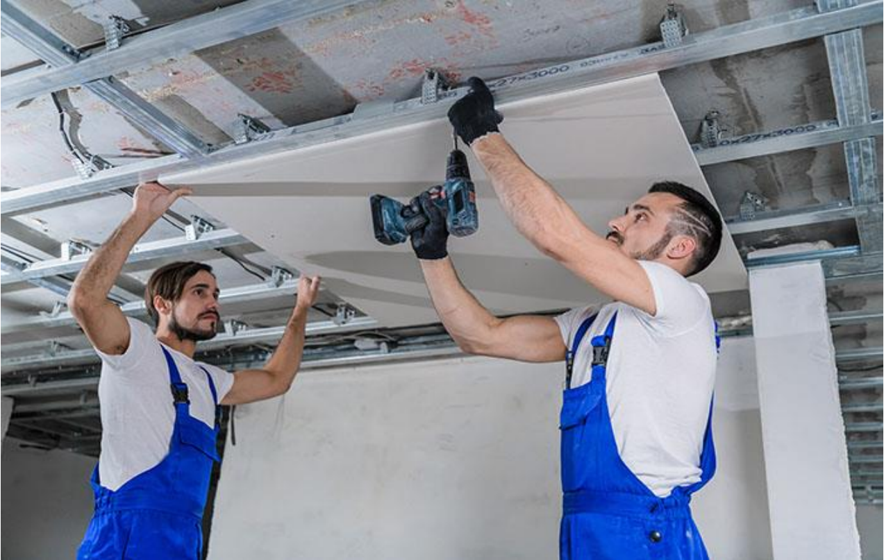
Imagen 25. Fijación de una placa de yeso laminado a los perfiles metálicos. Fuente: Reves
