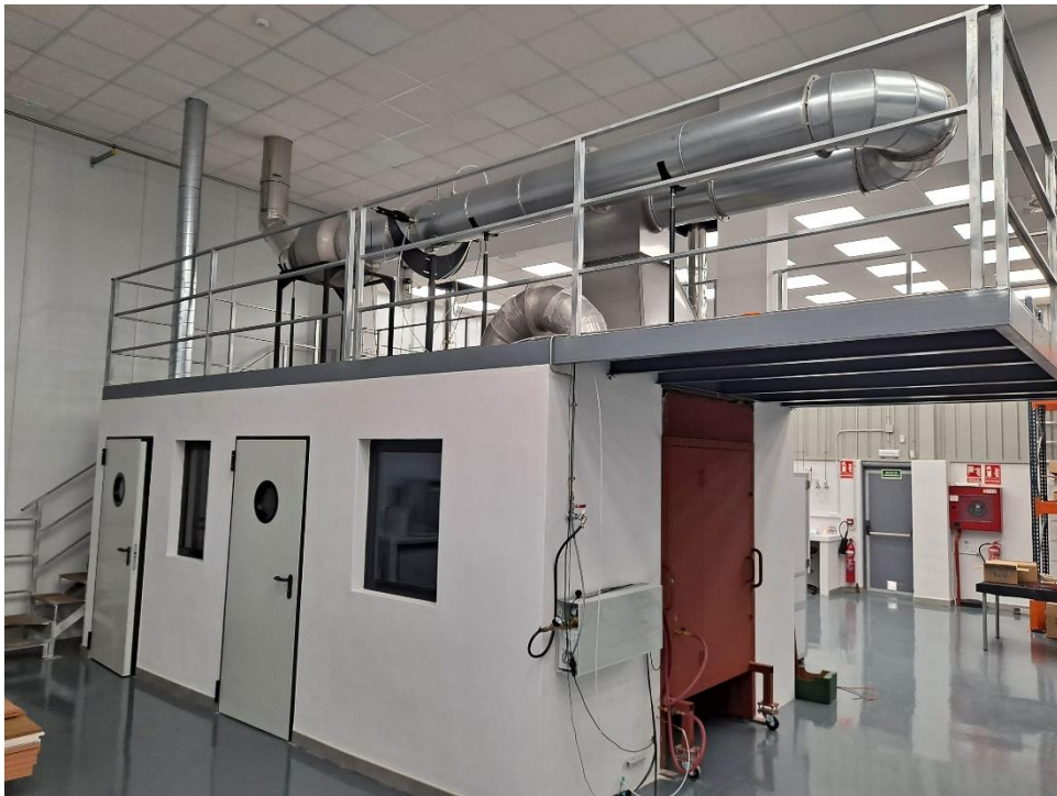
Figura 13. Imagen del equipamiento SBI en instalaciones de AIDIMME
