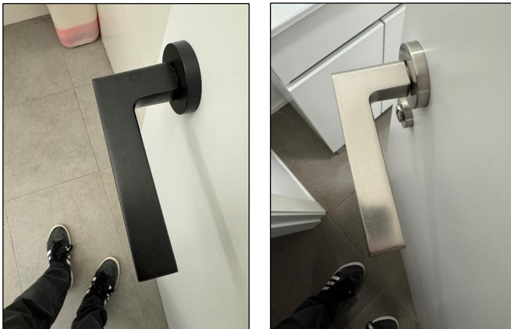
Ilustración 11 Estado del recubrimiento en manivelas.
