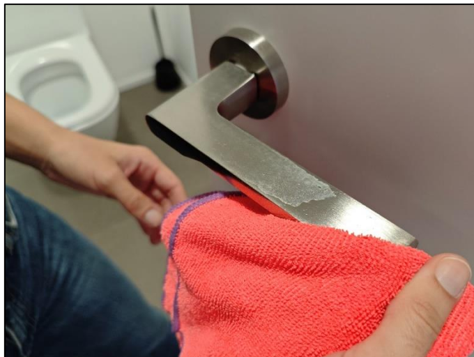
Ilustración 14 Estado del recubrimiento en manivela en PALBOX.
