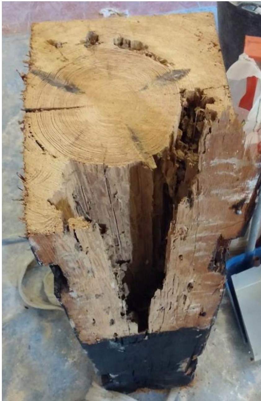
Imagen 2. Degradación de jácenas de madera de un palacio renacentista perteneciente al patrimonio histórico valenciano. Los daños ocasionados por termitas curvaron varios forjados de grandes luces.
