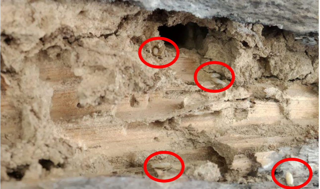
Imagen 3. Degradación activa por termitas en un edificio renacentista valenciano.
